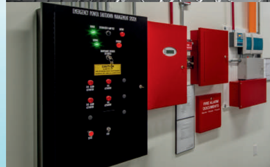
أنظمة إنذار الحريق
